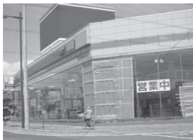
写真6 ガラススクリーン破損
