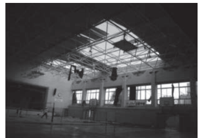
写真3 体育館屋根、内部の被害状況
