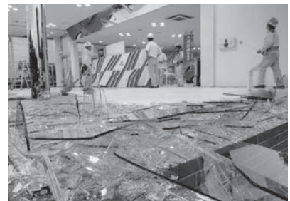
地震により面ガラス、方立ガラスが共に破損し全面脱落 (自動車ショールーム/日経新聞朝刊より転載)
