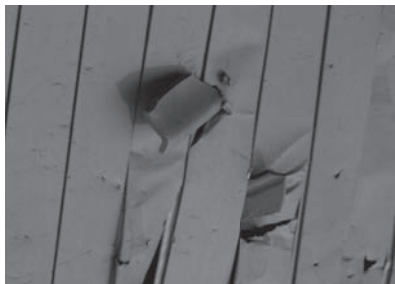
写真5 外壁の飛来物による衝突痕
