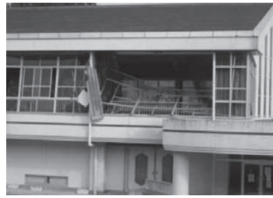
写真4 横連窓が窓枠ごと脱落 1
