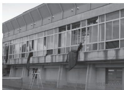
写真8 体育館窓ガラスの破損
