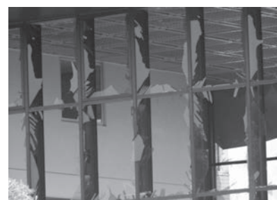
写真9 カーテンウォールのガラス破損脱落
