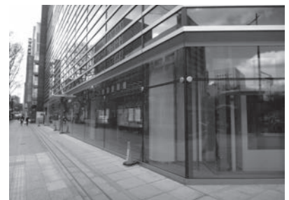
写真7 特殊構法(破損なし)
