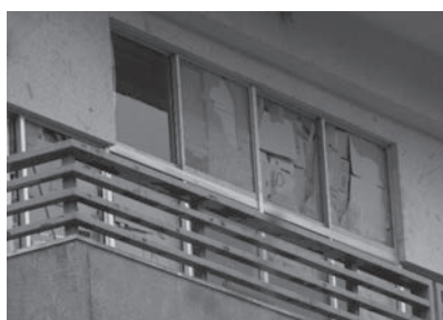
写真7 学校校舎の窓ガラス破損脱落
