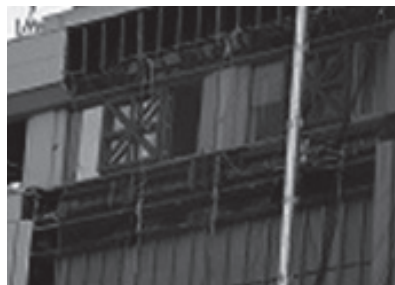
写真2 ALCパネル脱落
