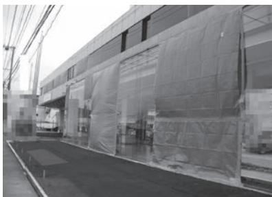
写真5 ガラススクリーン破損
