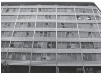
地震時の層間変形による破損 (東京大学/清家剛准教授提供)
