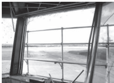
宮古空港管制塔 (建築研究所提供)
