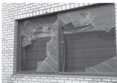
写真10 飛来物による破損 (網入板ガラス)
