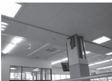
写真8 柱周りガラス破損脱落
